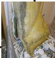
濡れた断熱材のカビ
